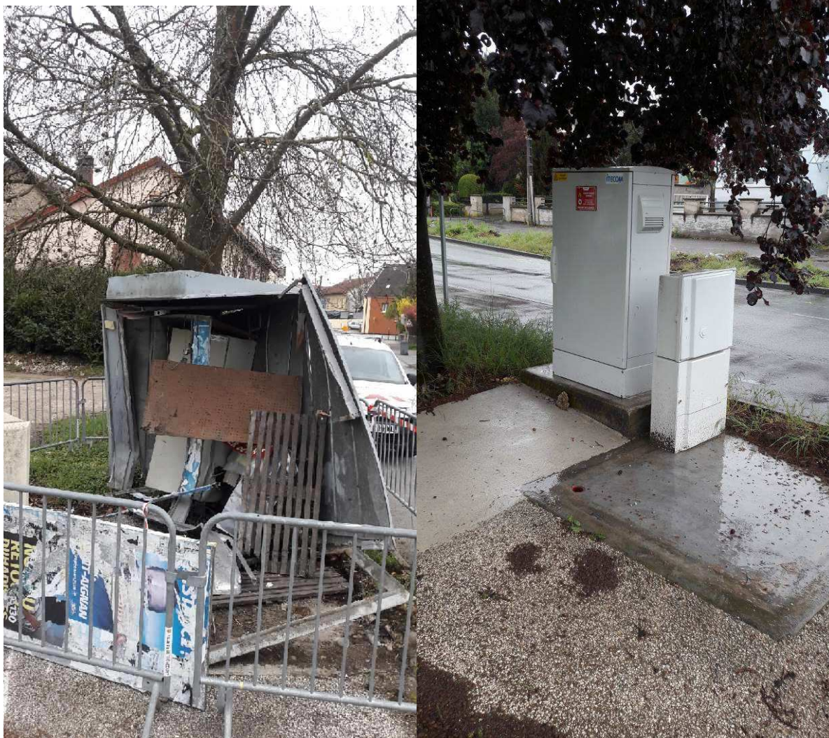
Poste de relevage Ecole à Bethoncourt, au moment du sinistre / après réfection
